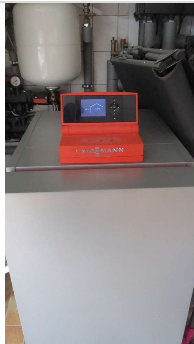
Haus 2 EG - Wärmepumpe
