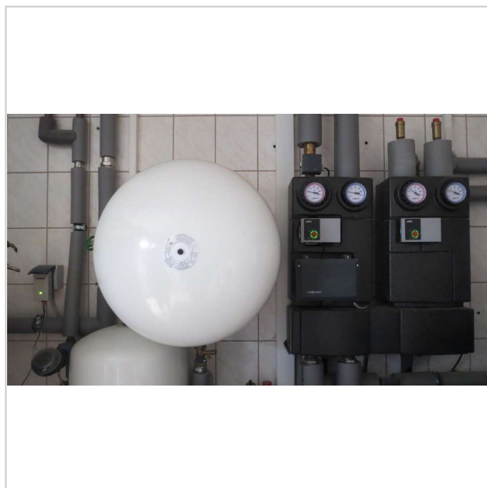
Haus 2- EG Pumpen Hzg.
