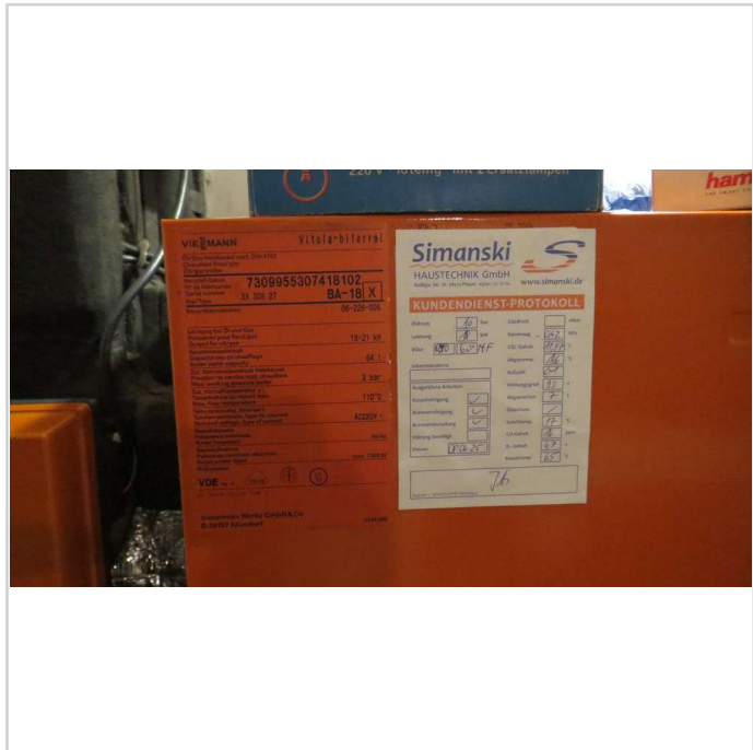
Viessmann Heizkessel mit WW
