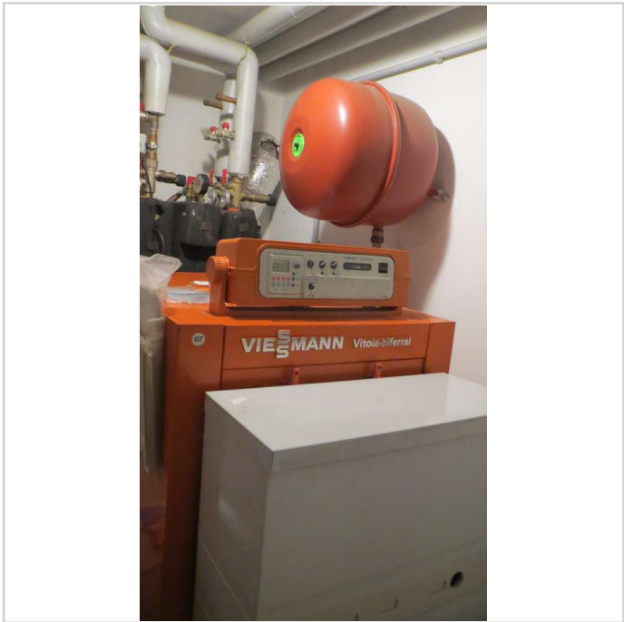
ÖL- Heizung + WW Viessmann
